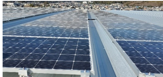
屋上に設置した太陽光パネル
